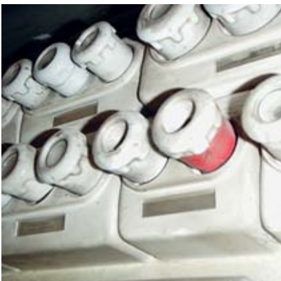
Bild 1: Defekter Keramikkörper. Es besteht Gefahr, sich zu elektrisieren.
