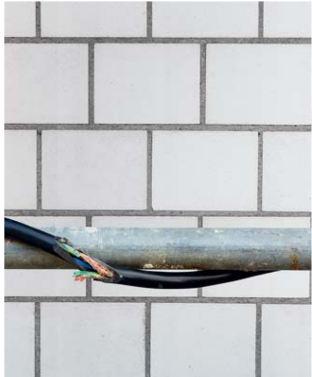
Bild 16: Defekte Kabel und Geräte einzusetzen lohnt sich nicht.
